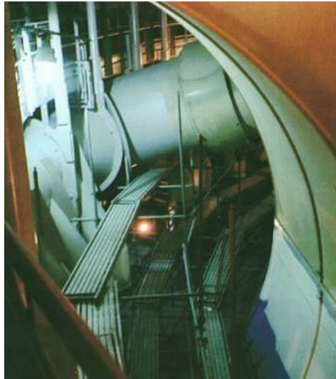
Fot. 4. Widok wentylacyjnego rurociągu łączącego wewnętrzną przestrzeń pod obudową bezpieczeństwa z torusem. Wokół obudowy bezpieczeństwa takich symetrycznie rozmieszczonych wentylacyjnych rurociągów jest od ośmiu do dziesięciu. Ich średnicy zawierają się w granicach od 1,7 m do 2,1 m.
